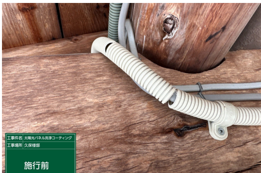
PF管補修前
