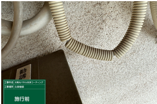
PF管補修前
