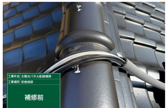
PF管補修前
